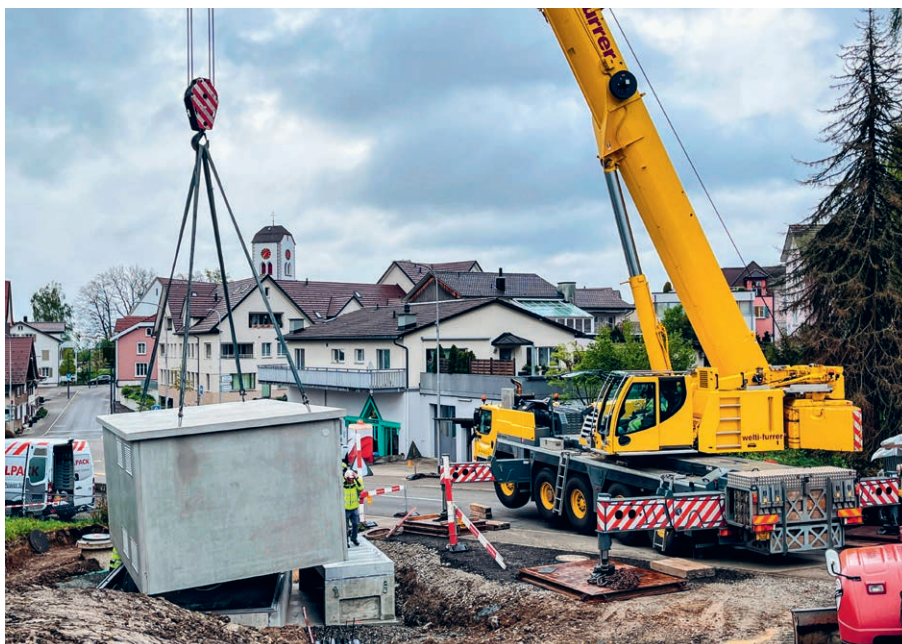
Neubau Trafostation Dorfegg / Quelle TB Waldkirch
